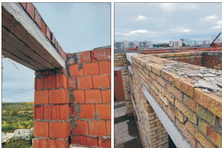
Рис. 1. Типичное состояние незаконсервированных конструкций жилого комплекса
