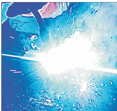
Рис. 3. Затрудненный обзор сварочной ванны продуктами горения цинкового покрытия
