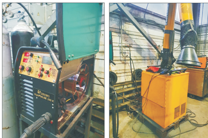
Рис. 2. Сварочный полуавтомат инверторного типа и локальная система очистки воздуха
