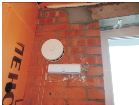
Рис. 3. Клапаны «КИВ-125» и «Домвент-Оптима», установленные на стене Fig. 3. Valves “KIV-125” and “Domvent-Optima” installed on the wall
