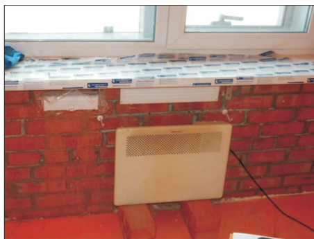
Рис. 4. Клапаны «БФК» и «Домвент-Оптима», установленные под окном Fig. 4. Valves of “BFK” and “Domvent-Optima” installed under the window
